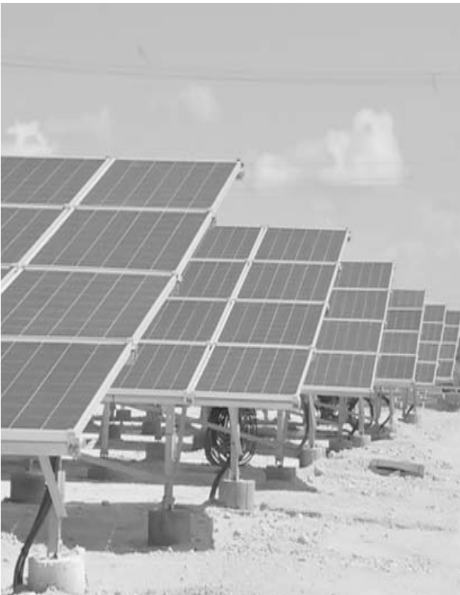
En el transcurso del 2013 se han construido parques solares fotovoltaicos conectados a la red eléctrica en diferentes provincias.
