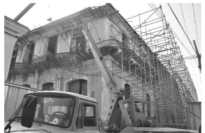
Ante el avanzado estado de deterioro de la edificación, los especialistas aconsejaron la consolidación de las estructuras en peligro. FOTO: VICENTE BRITO
