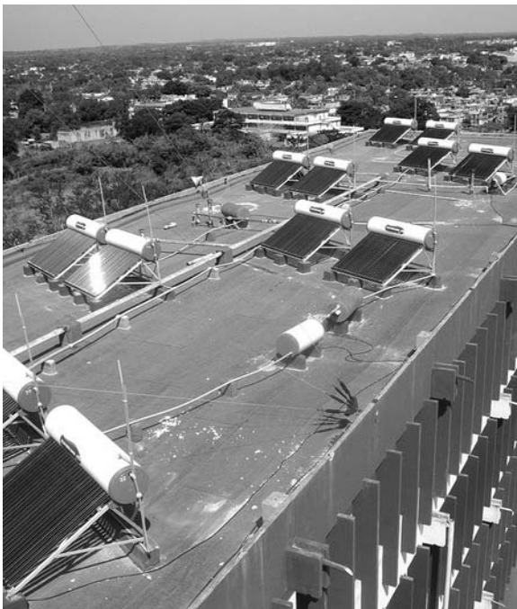
Calentadores solares en el techo del Hotel Las Tunas.
