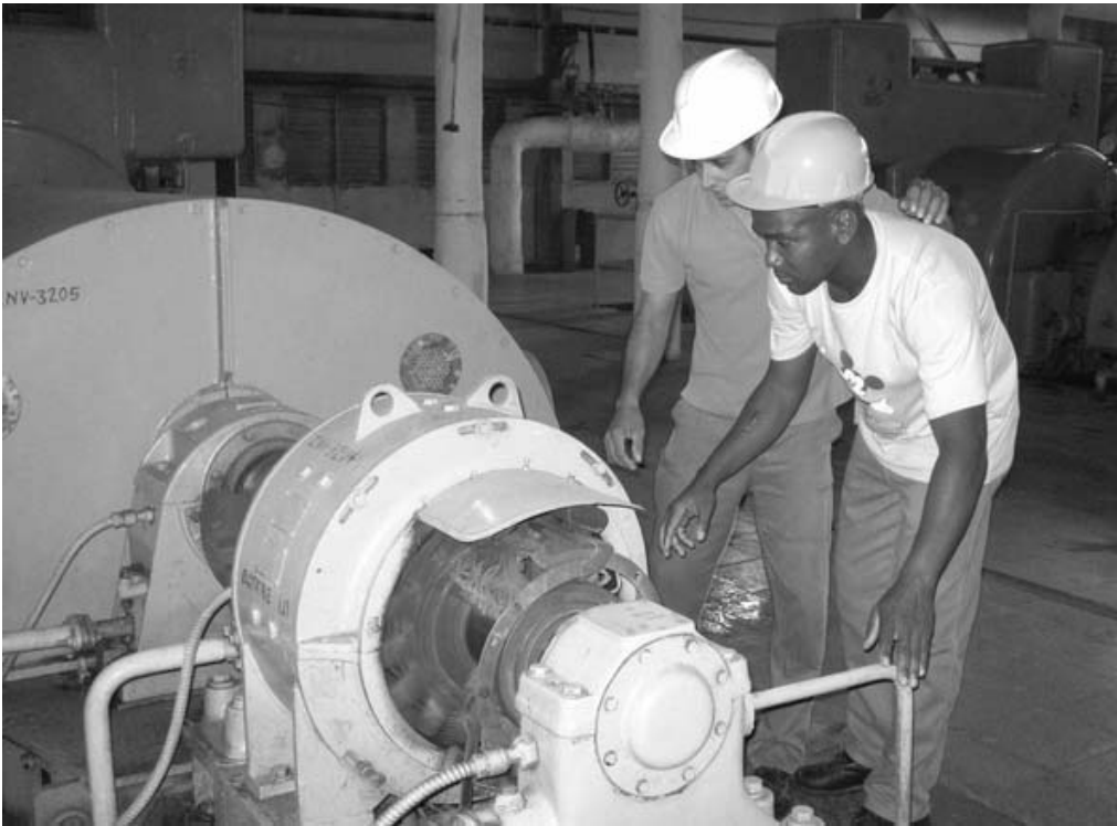
Yoleixis y Félix, dos de los operarios de la planta eléctrica, velan por la eficiencia energética del central.
