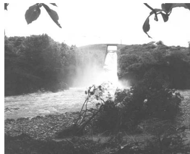
Los daños ocasionados por las intensas lluvias de junio del 2002 obligaron a ejecutar un reforzamiento emergente de la cortina de Lebrije. FOTO: RAFAEL A. RANGEL
