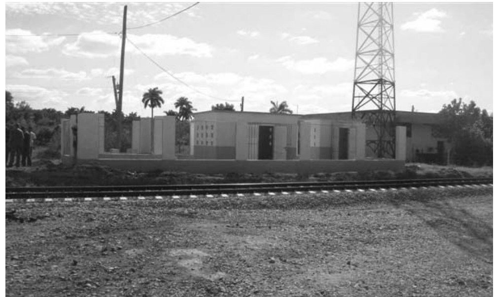
A veces se deben construir sitios tecnológicos intermedios para cubrir toda la cobertura.
