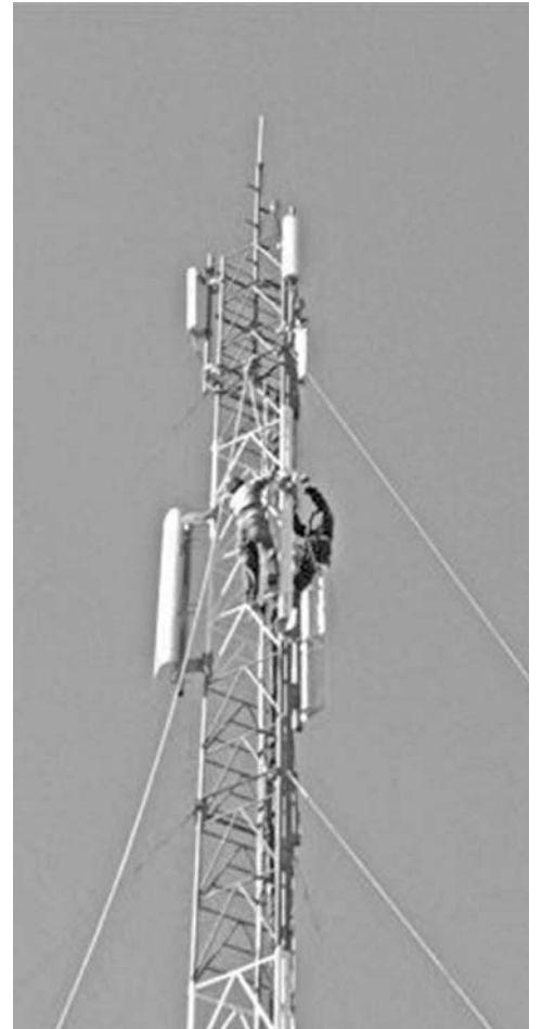
Alrededor de 80 torres y 90 grupos electrógenos con sus tanques de combustible auxiliares serán instalados. FOTO: UNIÓN DE FERROCARRILES
