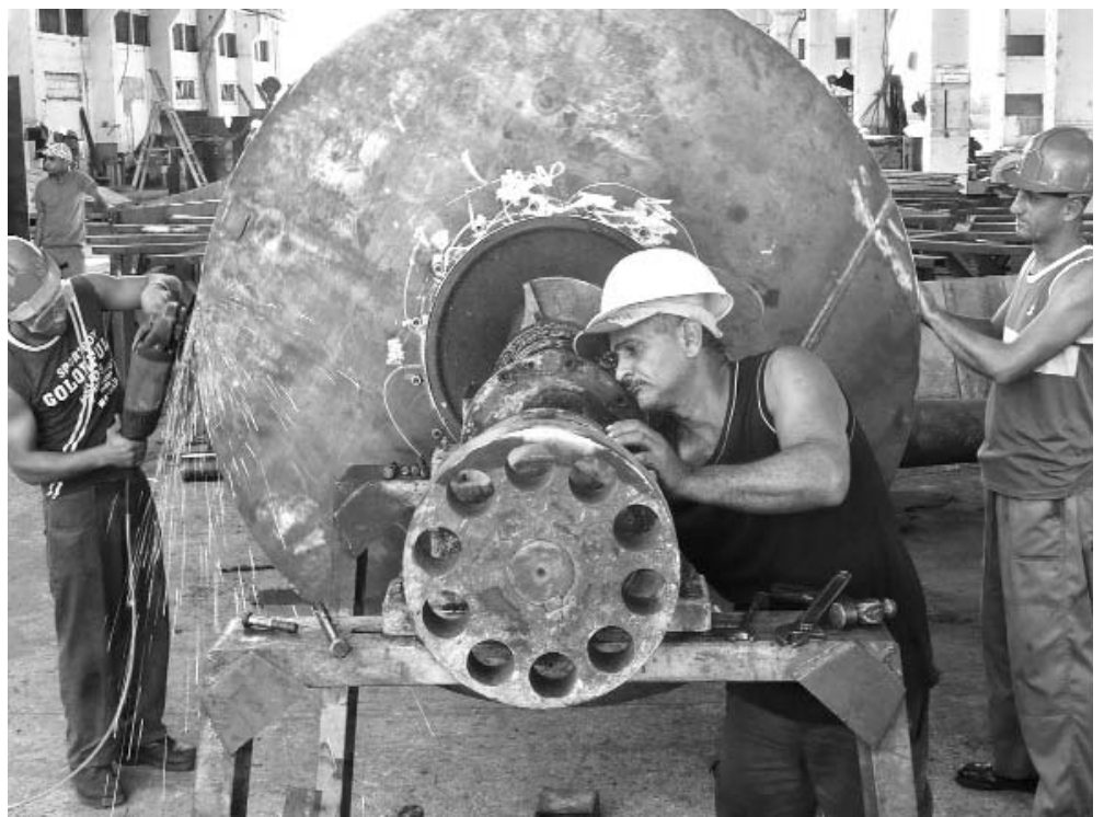
Un extraordinario esfuerzo exigió la terminación de los 24 enormes ventiladores.
