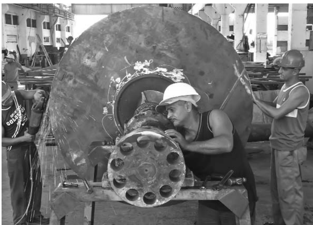
En ensamblaje, pailería y restantes áreas, la entrega permite asegurar el cumplimiento de los compromisos anuales.
