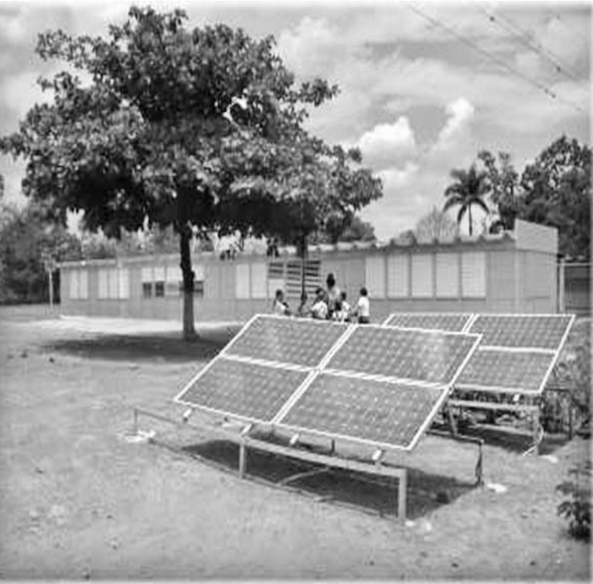
El uso de la radiación solar para producir calor y energía eléctrica constituye una realidad que se incrementa en el país.
