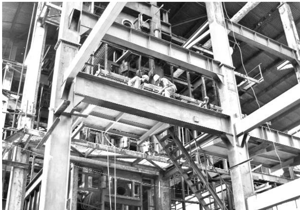
En el área de generación de vapor se montará una caldera nueva de 60 toneladas y se reparará otra de 40. FOTOS DEL AUTOR
