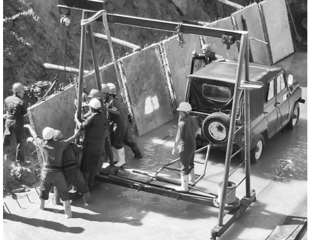
Este muro, que todavía nadie ayuda a romper, ha demorado más la puesta en marcha de la planta.
