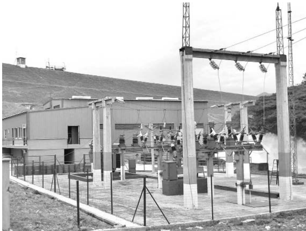
En servicio, la Pequeña Central Hidroeléctrica de Bueycito habría aportado energía limpia y ahorrado miles de toneladas de combustible. FOTOS: CORTESÍA HIDROENERGÍA GRANMA
