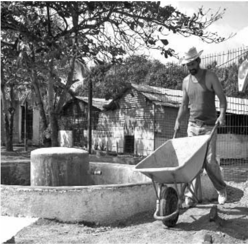
La finca El Regreso, especializada en la producción porcina, cuenta ya con su planta de biogás. FOTO DEL AUTOR
