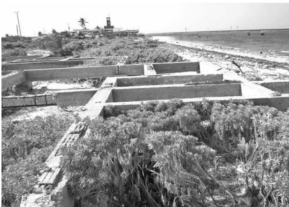
Estas estructuras, como otras muchas en Santa Lucía, fueron levantadas a escasos metros del mar.
