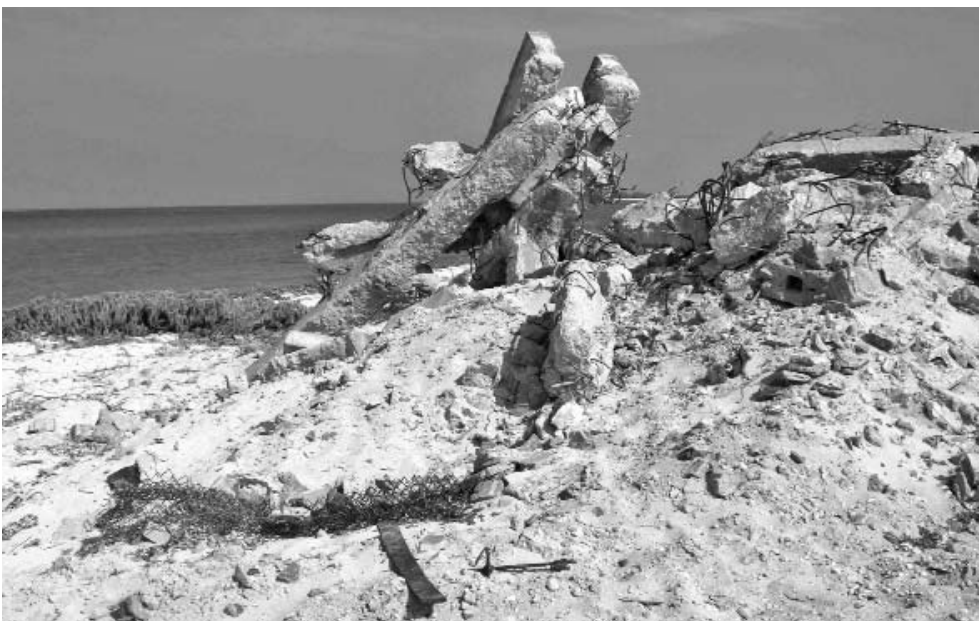
Una vez demolidas las construcciones, se requiere la extracción oportuna de los escombros.
