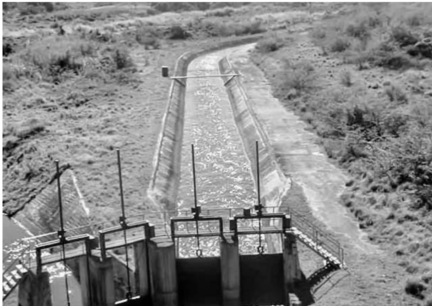
El canal Pedroso-Güira es una de las alternativas que se emplean para el trasvase de agua.
