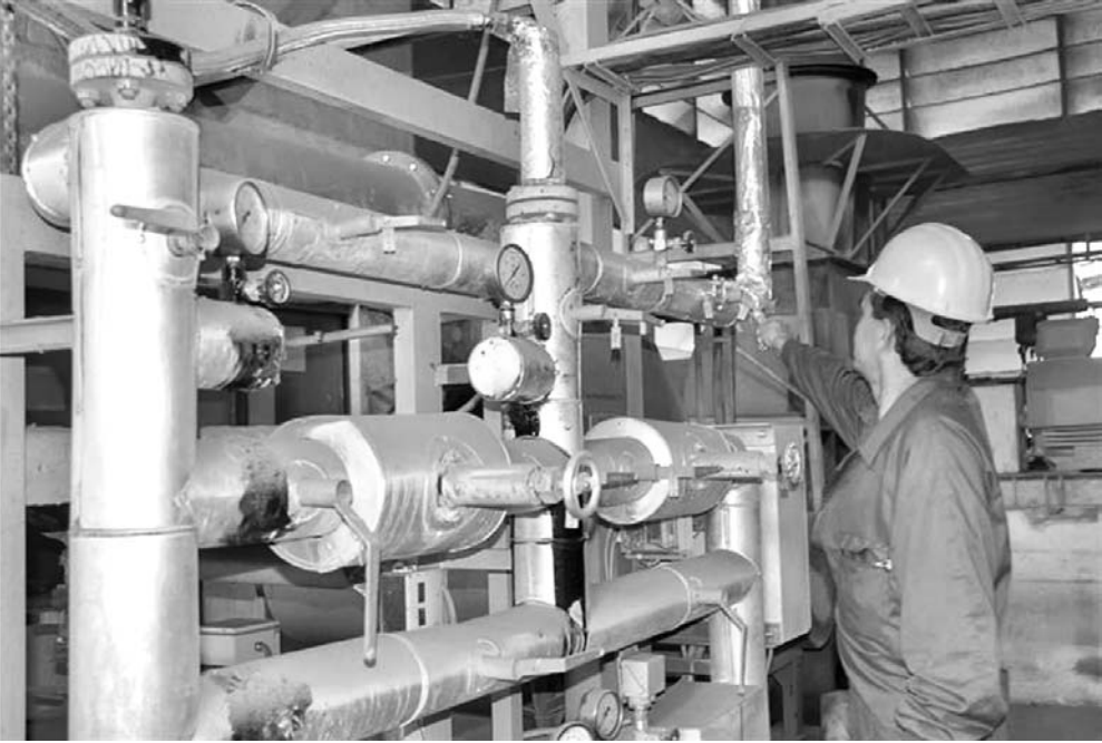
La fábrica de cemento Siguaney está en condiciones de realizar las adecuaciones tecnológicas para asumir la producción de este nuevo producto. FOTO: VICENTE BRITO
