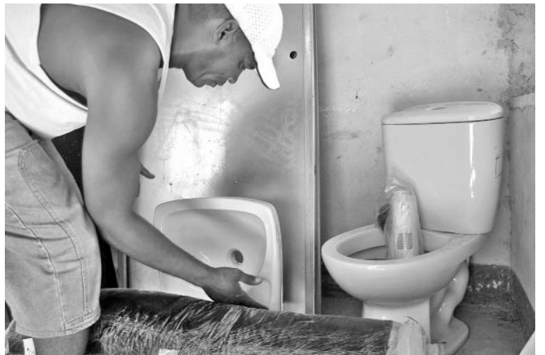
En el transcurso del 2011, varios surtidos de materiales de la construcción presentaron problemas de calidad y acabado final. FOTO: YAIMÍ RAVELO
