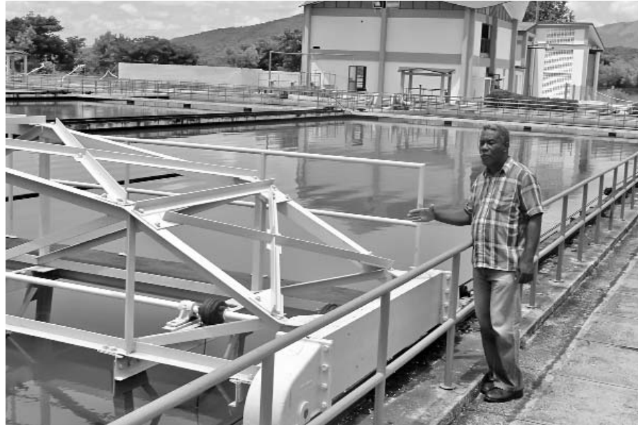
Bien terminada, capaz de entregar con sus dos plantas 2 400 litros de agua por segundo, la remodelación convirtió a Quintero en el mayor sistema potabilizador. FOTO DEL AUTOR
