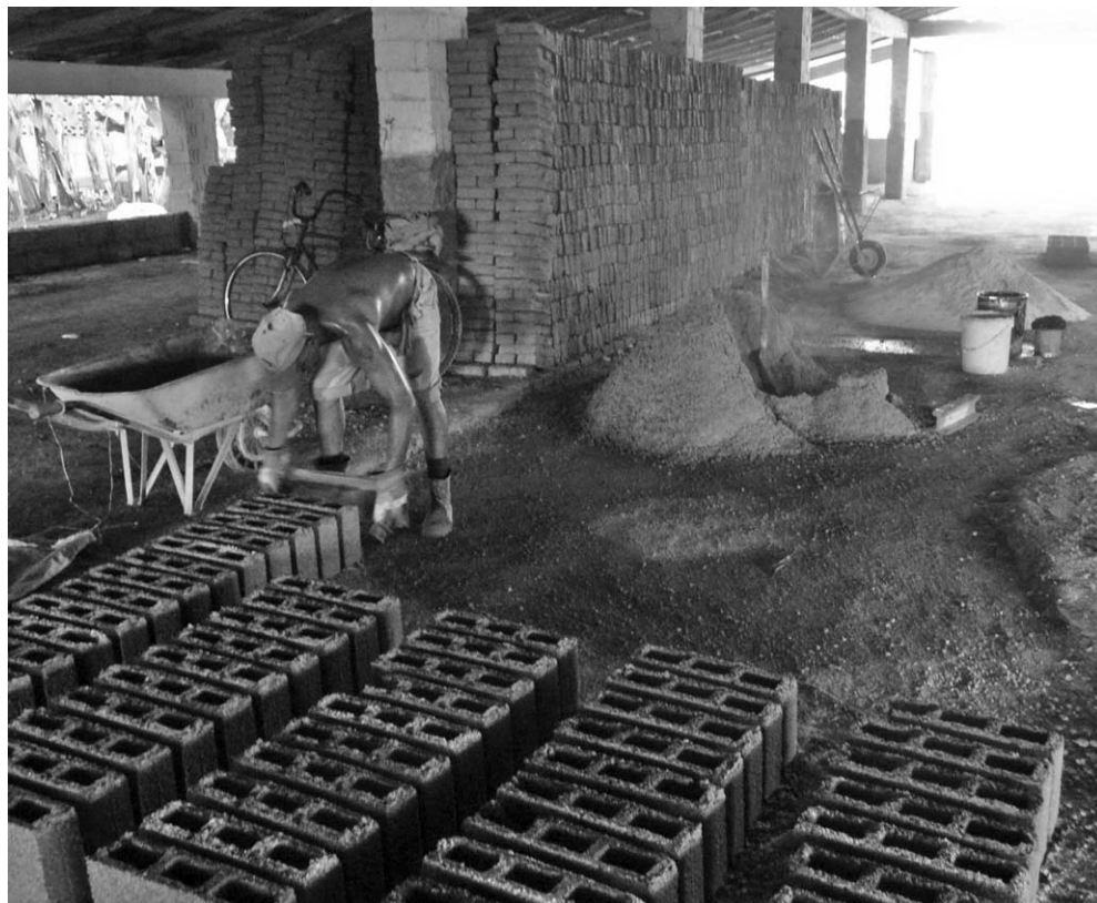
Cada hombre produce manualmente 130 bloques de hormigón en medio día. FOTOS DEL AUTOR
