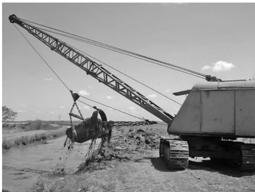
Las acciones de limpieza resultan insuficientes, dado el alto grado de contaminación existente en la red fluvial. FOTOS DEL AUTOR
