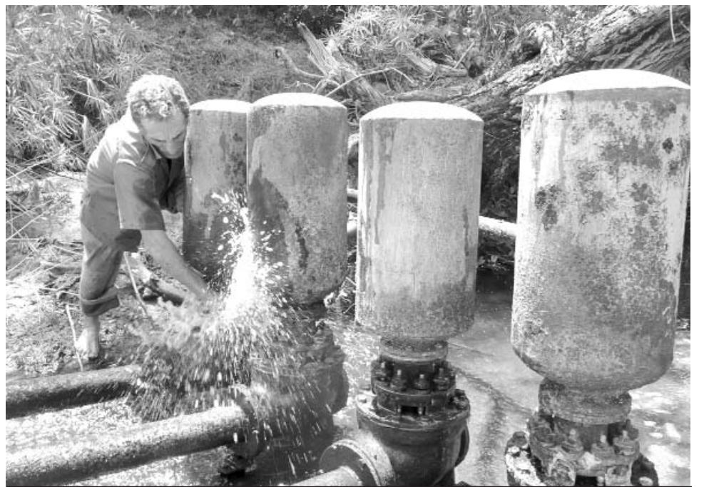
Sin mantenimiento sistemático, la vida útil de los arietes hidráulicos también disminuirá en las zonas serranas, donde se cree que es más económica la explotación.
