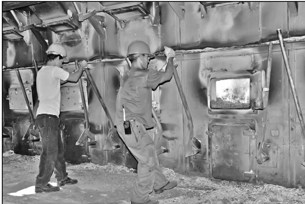
Gran estabilidad muestra el área de generación de vapor: Foto: Nohema Díaz
