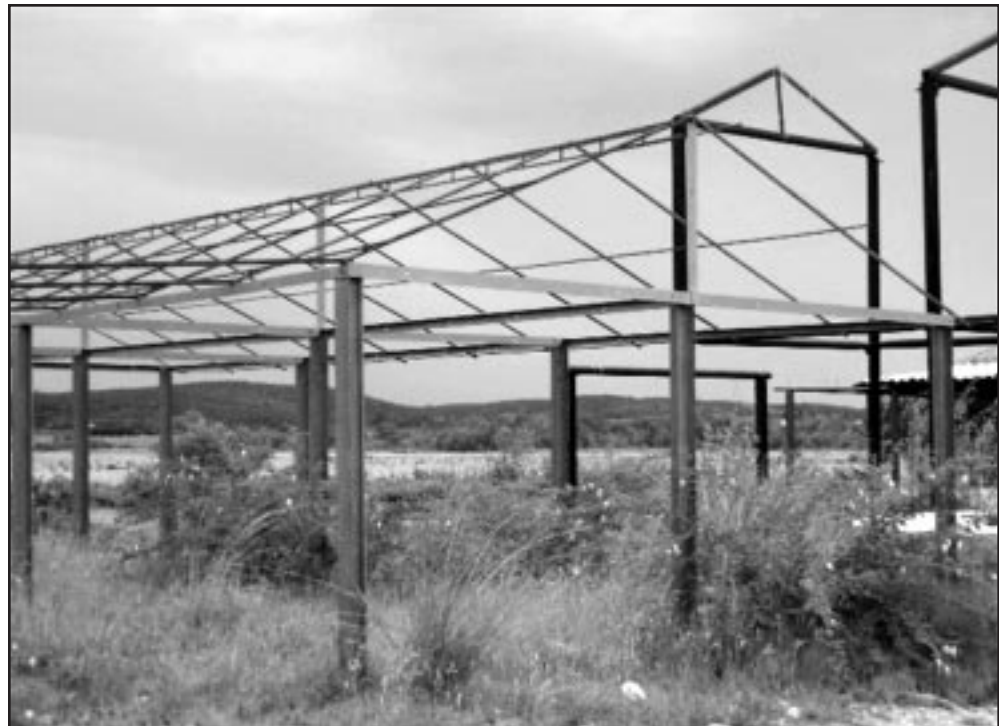
Utilizaron tantos hierros, que uno se pregunta qué hubiera sucedido si una tormenta eléctrica afectaba la zona.
