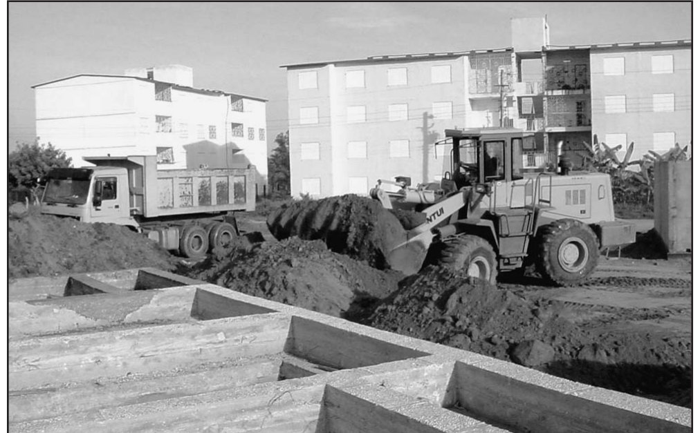
Fuerzas de la construcción aceleran en Los Coquitos los trabajos de cimentación de los nuevos edificios.
