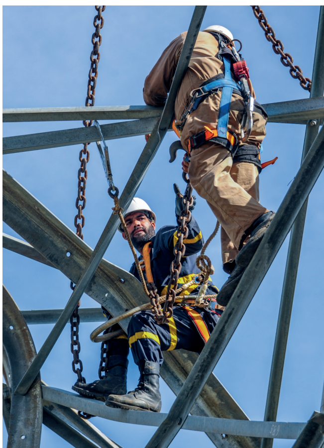
Levantar las torres de alta tensión derribadas por los vientos fue una hazaña tras el paso del huracán Rafael. FOTO: JOSÉ MANUEL CORREA
