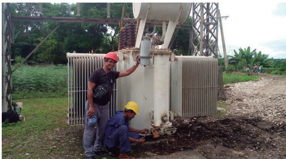
El robo del aceite del transformador anterior obligó al montaje e instalación de otro transformador potente, para proveer energía a varias comunidades. FOTO: BÁRBARA VILA
