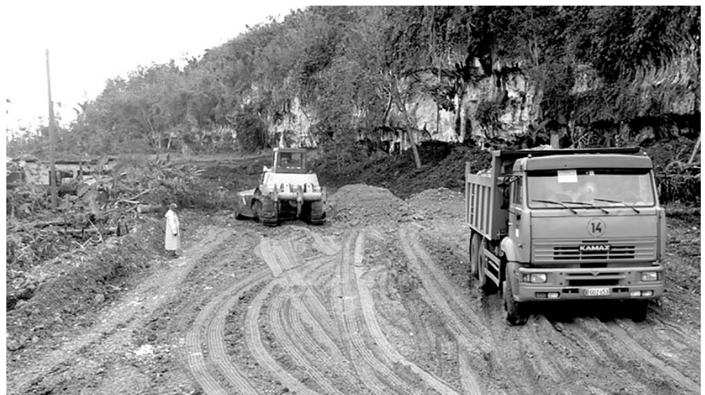
Excavación del material indeseable y relleno con mejoramiento para conformar el terraplén. FOTO DEL AUTOR
